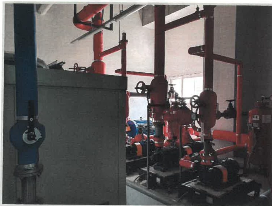
[건물 2층 소방관련 기계실 등]
